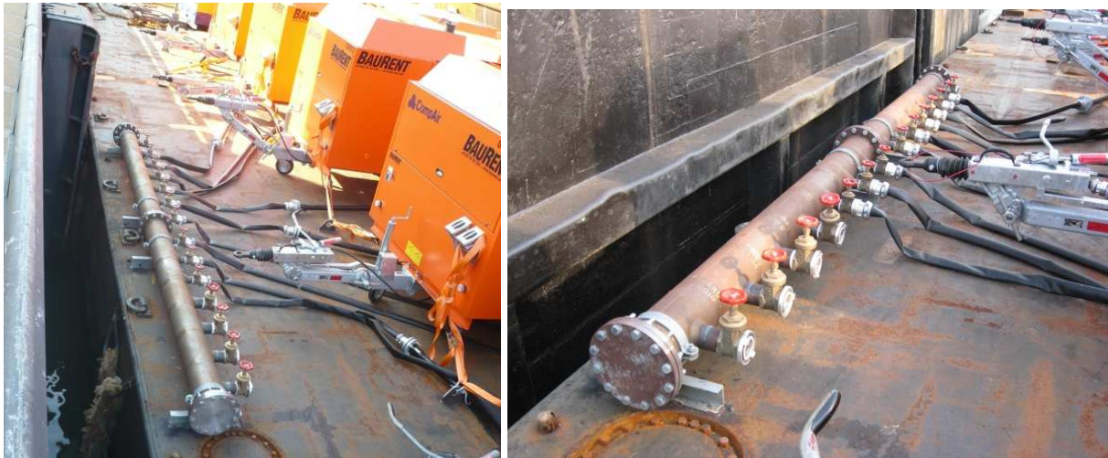
Bild 6.3: Druckluft-Sammelstation mit flexiblen Schläuchen zu den Kompressoren sowie zur Ringleitung.
